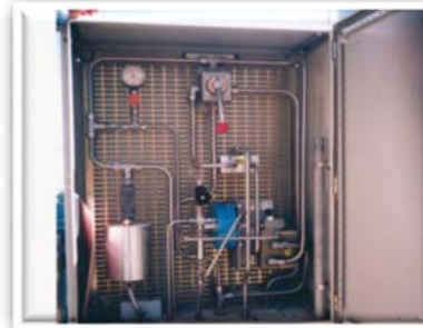
تابلو پنوماتیک LBV شرکت ملی گاز
