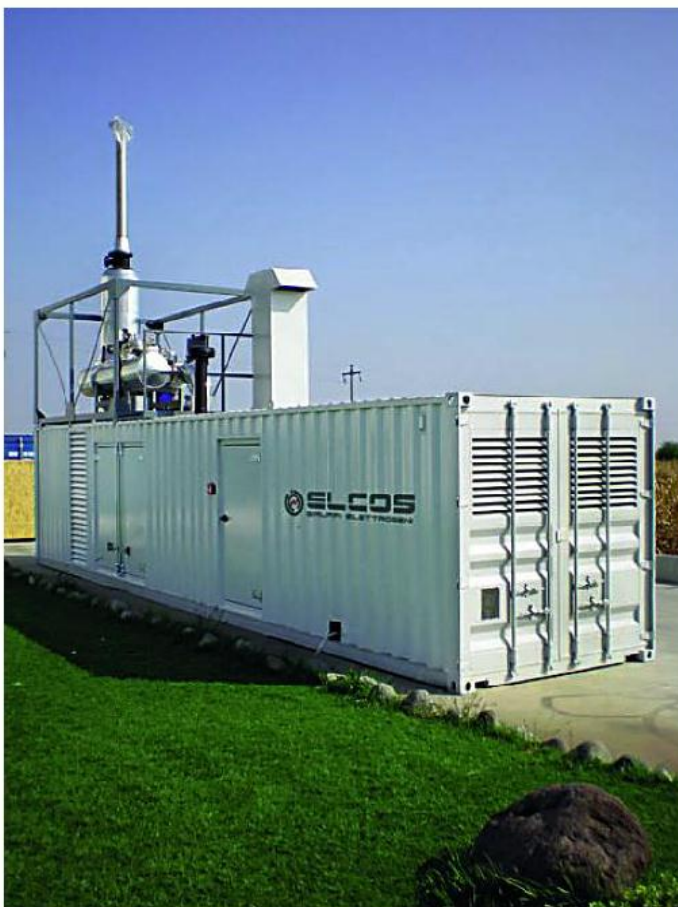
CONTAINER 40" 800 kVA 60 db(A) a 7 mt. con recupero termico e quadro parallelo rete
